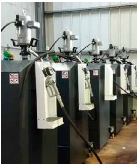
Pompes montées sur cuves
