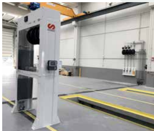
POSTES DE DISTRIBUTION
